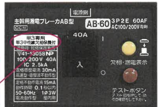
漏電ブレーカーの拡大写真
